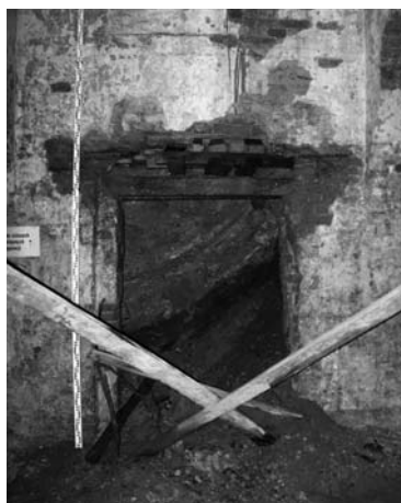
Rys. 8. Zagruzowane przejście w dawnym Więzieniu
