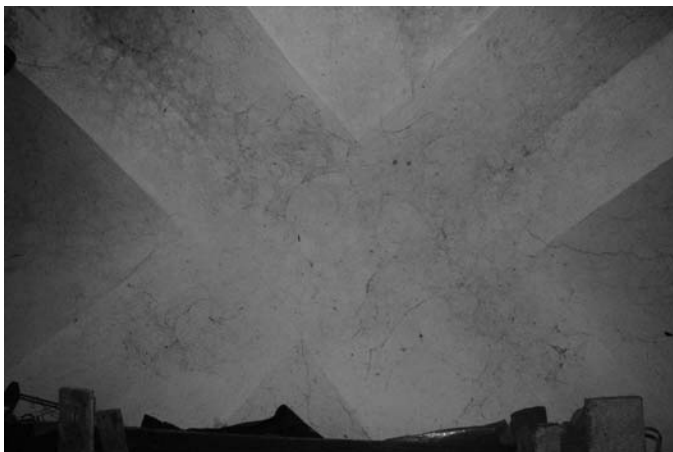
Rys. 4. Widok sklepienia komory z pęknięciami sklepienia — dawne Wójtostwo
