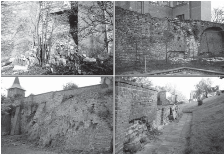
Rys. 7. Zniszczenia konstrukcji i pęknięcia murów
