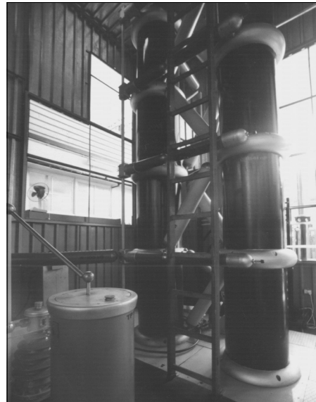
Rys. 7. Generator GU-400 – widok konstrukcji
