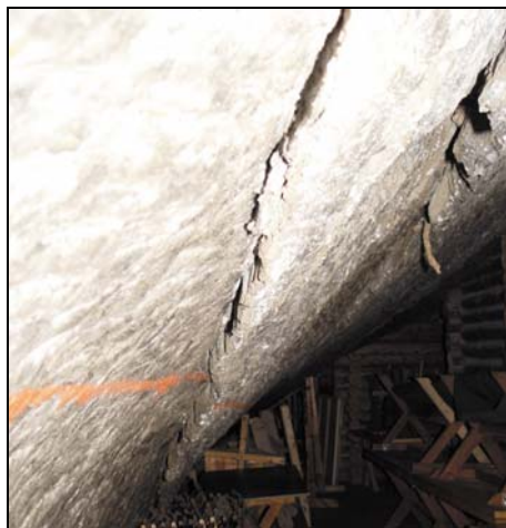
Rys. 4. Łuszczenie się skorupy solnej w północnym ociosie komory „Ważyn”
