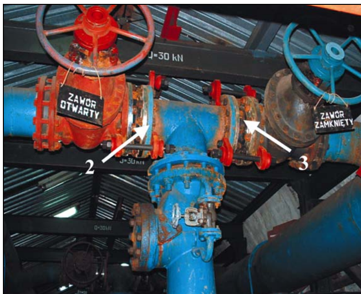
Rys. 4. Kompensatory gumowe zabudowane na kolektorze pompy.
