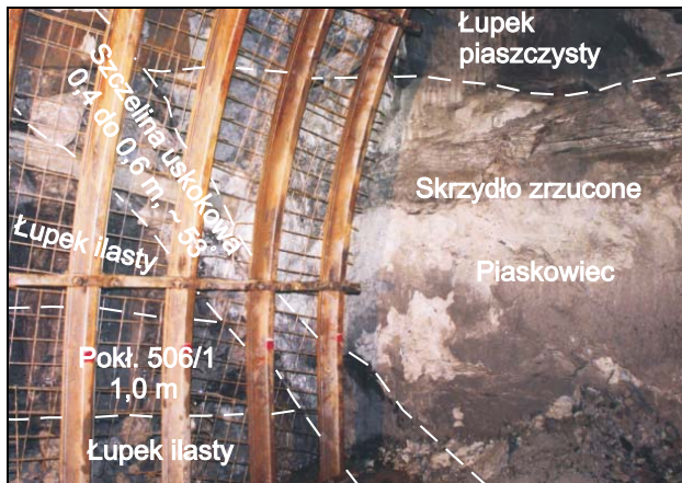
Rys. 4. Widok szczeliny uskokowej uskoku andaluzyjskiego, ocos południowy przekopu łączącego 1
