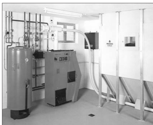
Rys. 4. Bezobsługowa kotłownia z piecem retortowym
