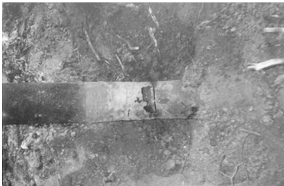
Rys. 9. Zerwany gazociąg stalowy (siły rozciągające)
