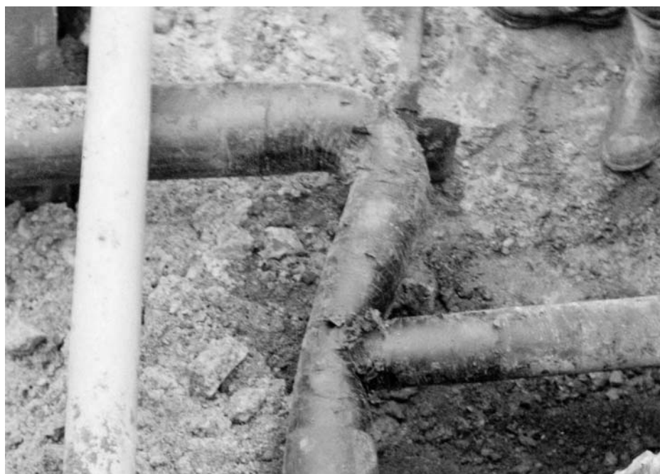
Rys. 10. Wygięty gazociąg w wyniku naporu rury na odgałęzieniu
