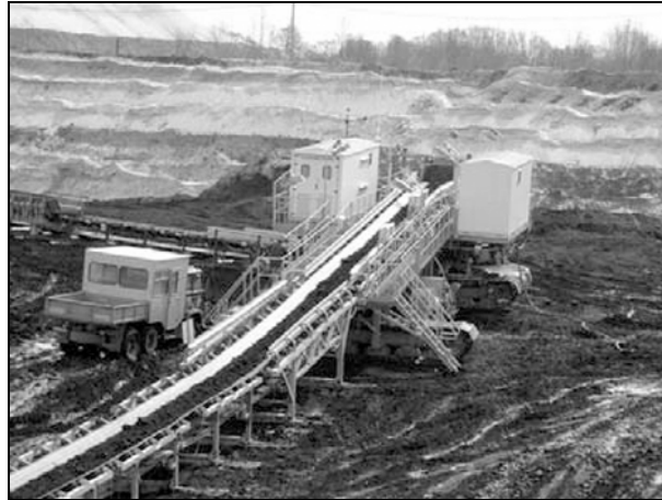
Rys. 6. Widok kontenera stacji napędowej (po lewo) przenośnika węglowego z regulowaną prędkością taśmy 1,5÷6,0 m/s w KWB „Konin”. Dwa energoelektroniczne przemienniki częstotliwości sterują dwoma silnikami klatkowymi 315 kW/500 V
