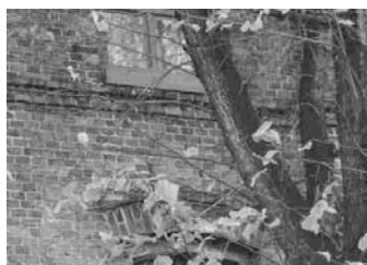
Rys. 11. Uszkodzenie w rejonie ul. Magdorzka
