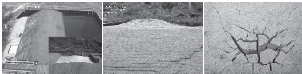
Rys. 1. Wał ochronny uniwersytetu w Hanowerze — symulacja uszkodzenia wewnętrznego stoku
